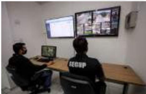
Sistema de Videomonitoramento.
