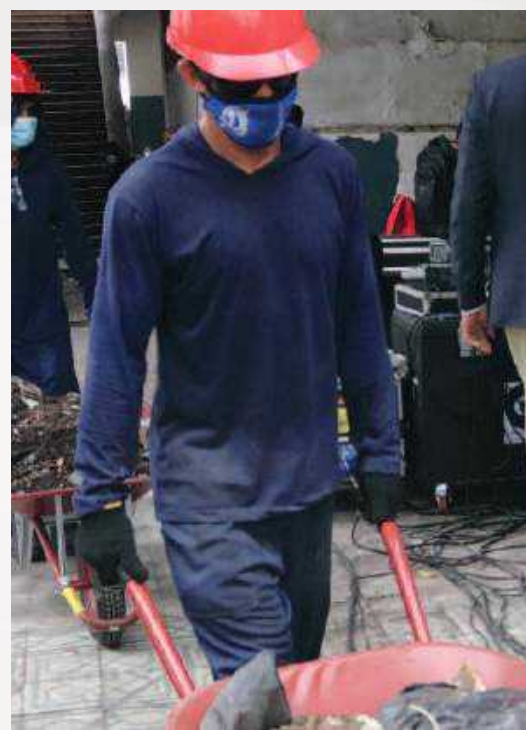
Trabalhadores atuando na obra de restauração do prédio histórico do Comando de Missões Especiais, localizado no bairro da Cremação, em Belém.
